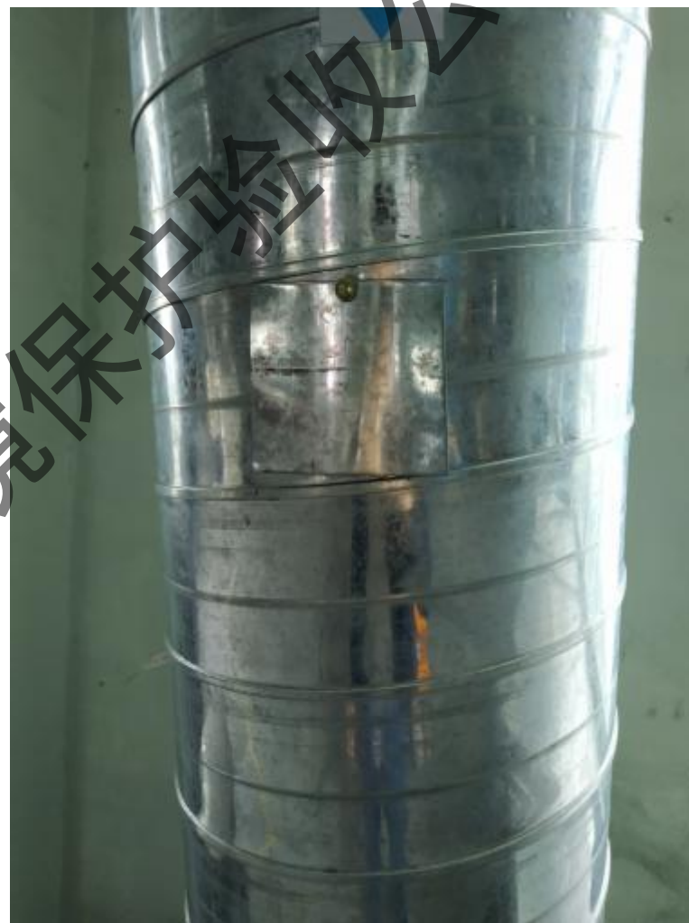
废气监测采样口
