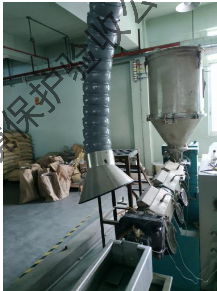
废气收集设施（集气罩）
