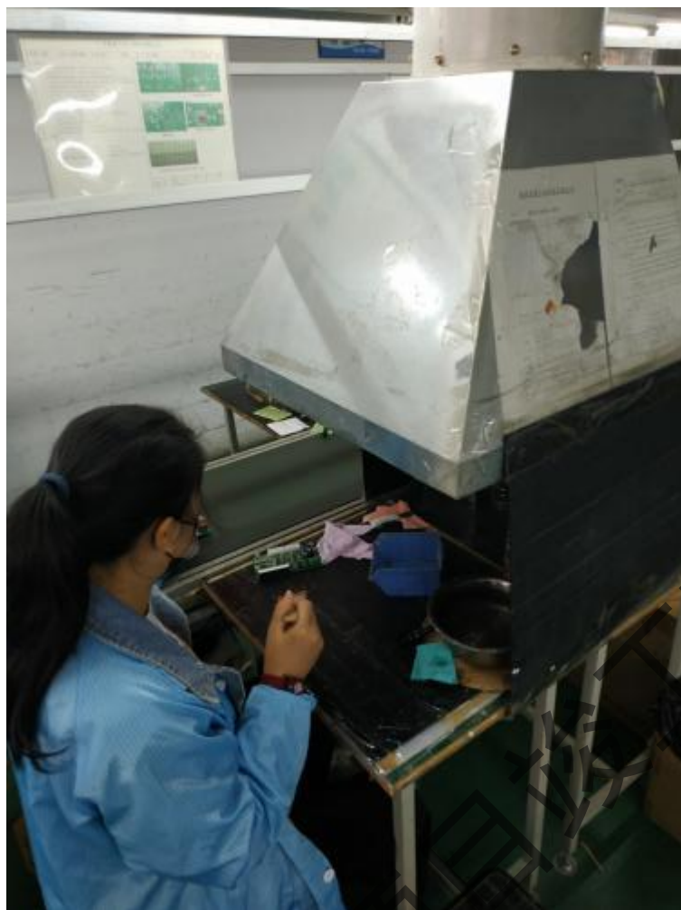
废气收集设施（集气罩）
