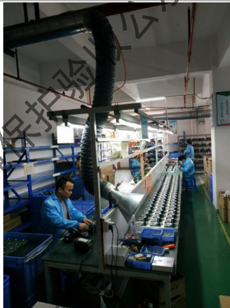
废气收集设施（集气罩）
