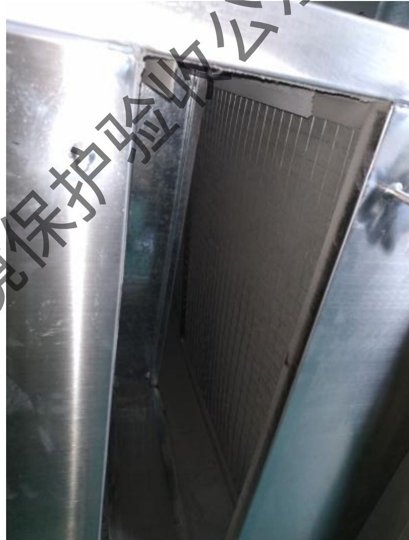
废气处理设施（过滤棉）
