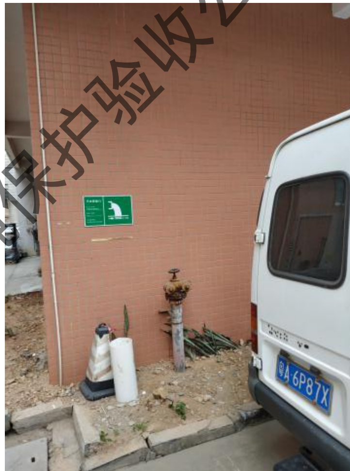
生活污水排放口 远照
