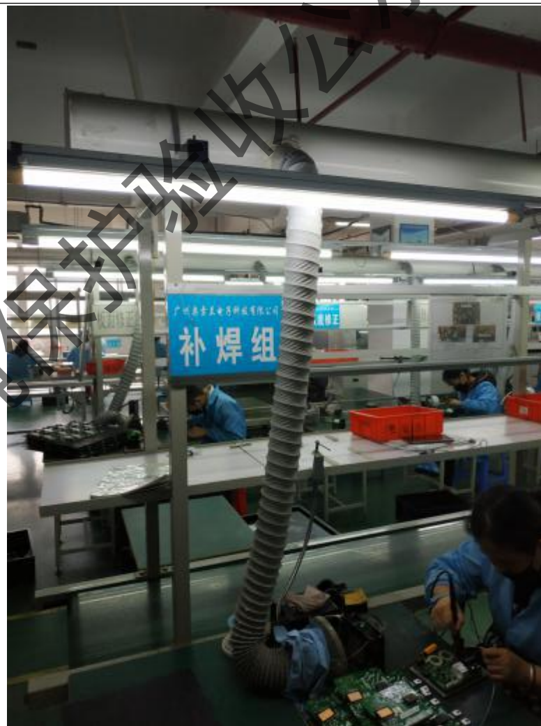
废气收集设施（集气罩）
