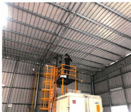
洁具炉废气排放口 3#
