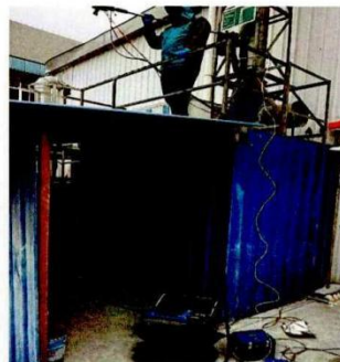
挤出有机废气排放口 DA002
