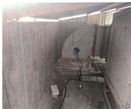
油烟治理设施前采样口 4#
