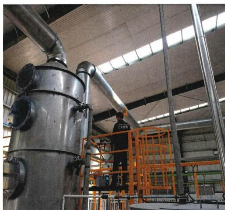
固化废气治理设施前采样口 3#
