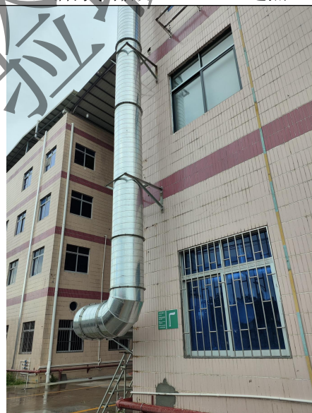
注塑废气排放口 DA001 远照
