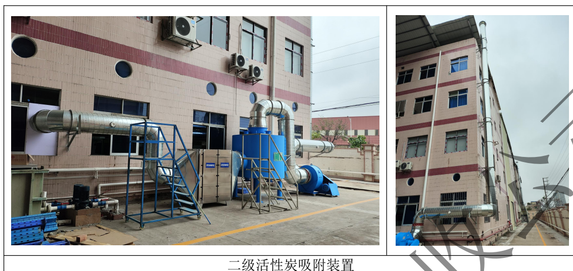
图 4.1-4 废气治理设施现场照片
