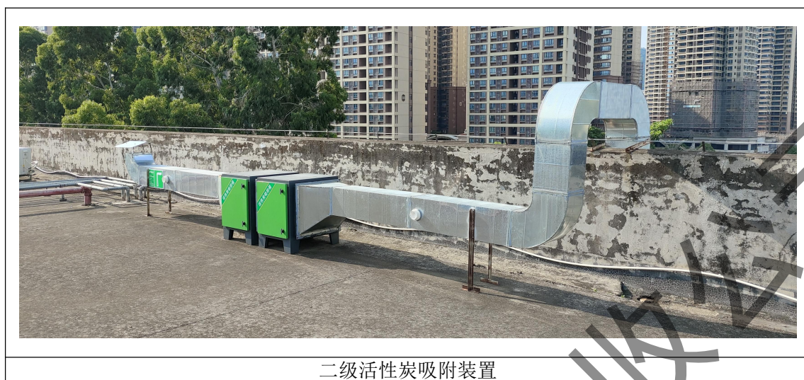
图 4.1-4 废气治理设施现场照片
