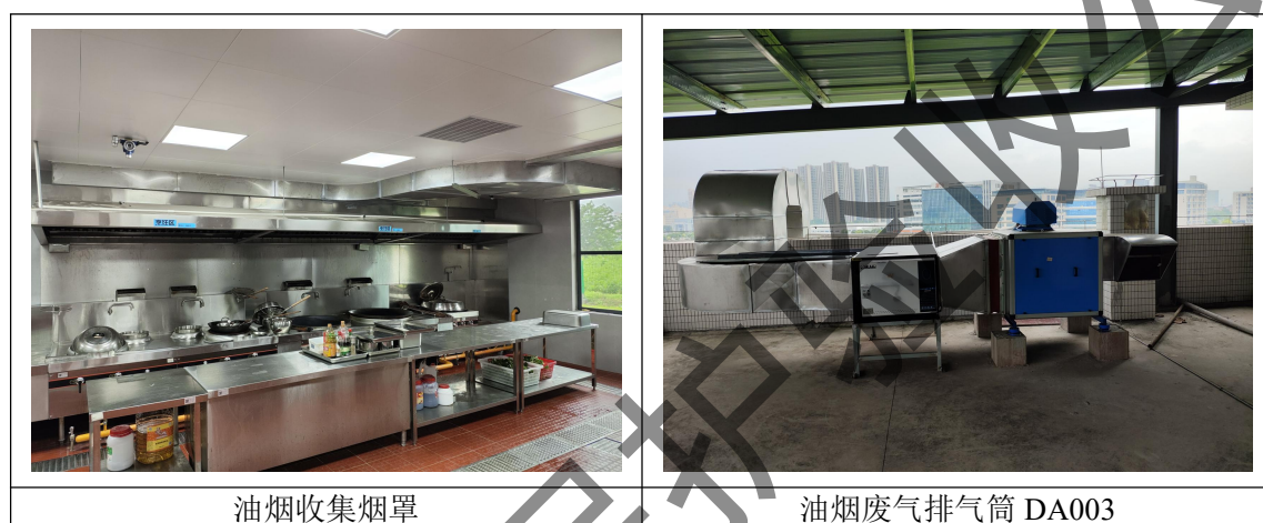
图 4.1-6 废气治理设施现场照片
