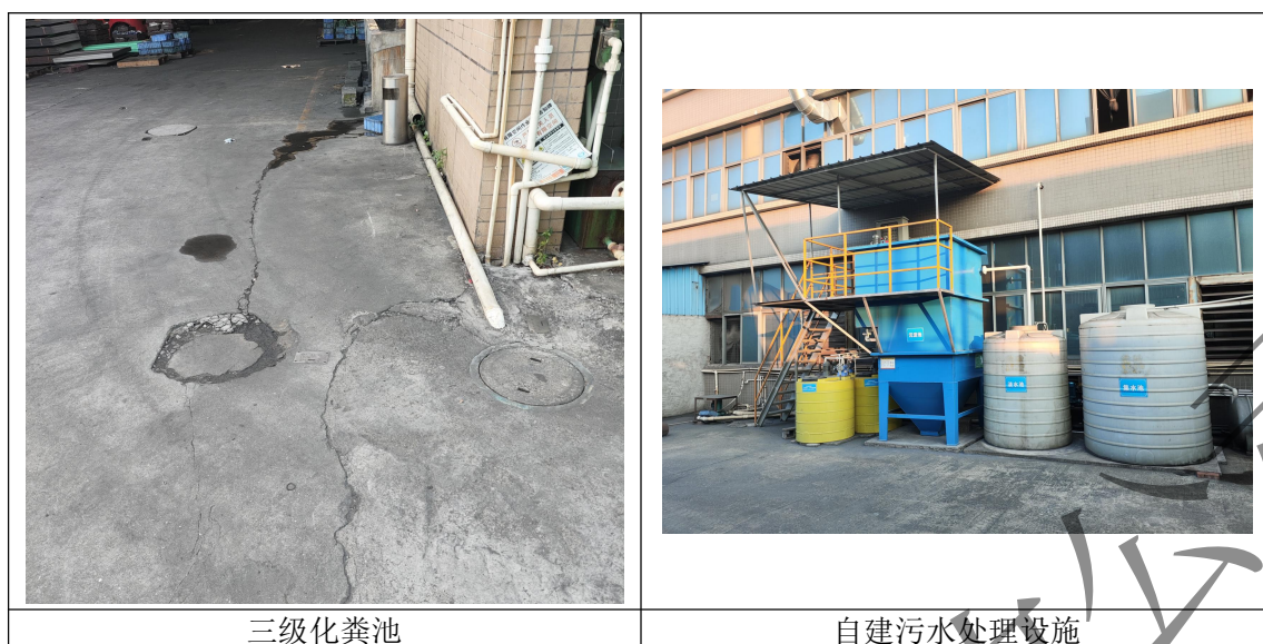
图 4.1-3 废水治理设施现场照片
