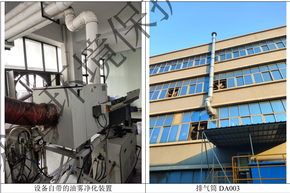
图 4.1-5 废气治理设施现场照片
