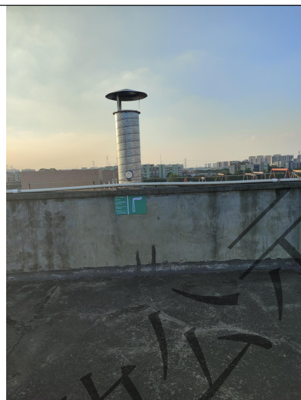
走心机机加工油雾排放口 DA003 远照
