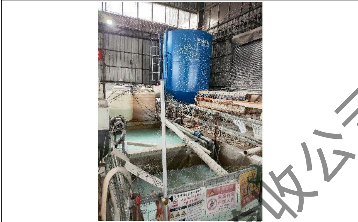
图 4.1-2 生产废水处理设施现场照片
