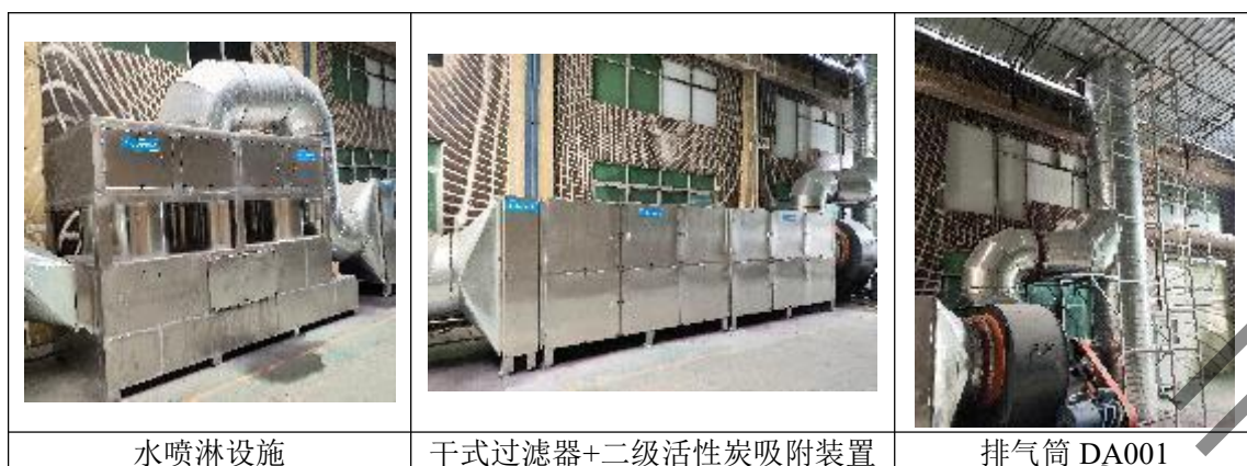
图 4.1-4 废气治理设施现场照片
