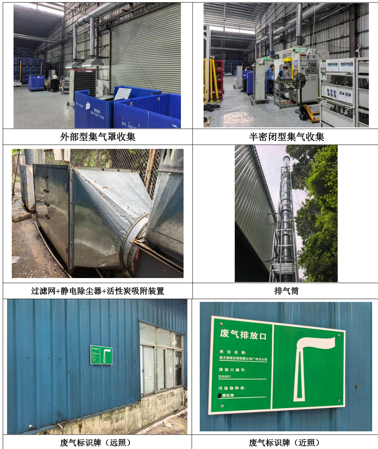
图3-4 废气收集设施情况
