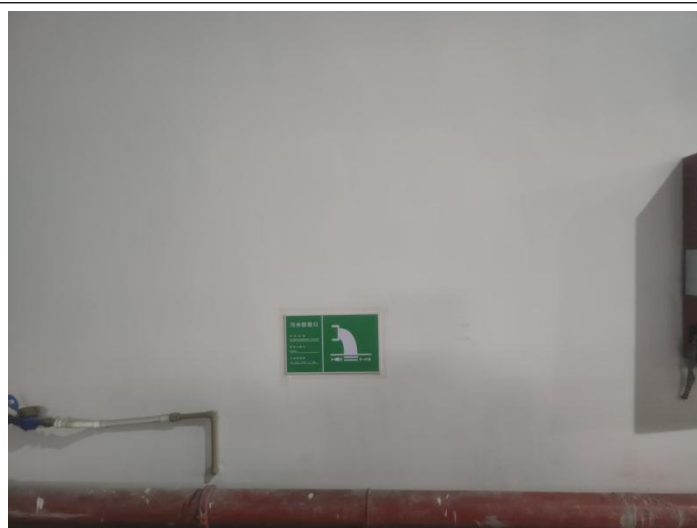
生活污水排放口
